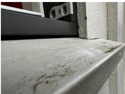
Kledning står nedtil vannbrett
