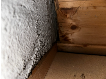
Fuktskjolder i undertak ved pipe.
