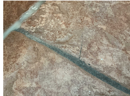
Sprekk i flis på gulv.
