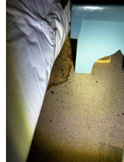
Fuktskjolder på gulvet ved mekanisk ventilasjonsanlegg.
