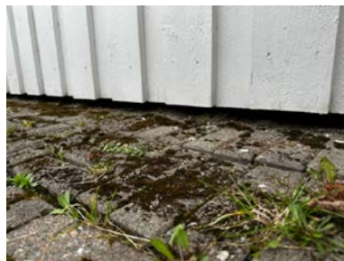
Kledning går nesten ned til terreng
