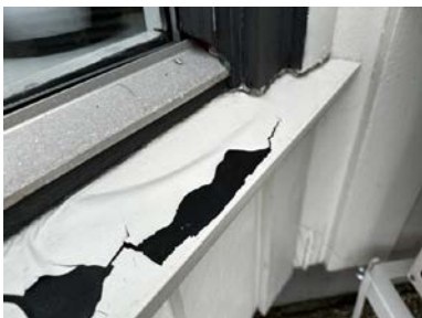
Avflassing på vindusbeslag
