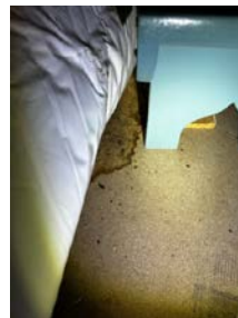
Fuktskjolder på gulvet ved mekanisk ventilasjonsanlegg.
