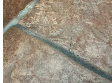
Sprekk i flis på gulv.
