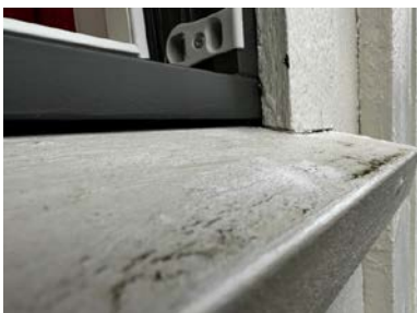
Kledning står nedtil vannbrett
