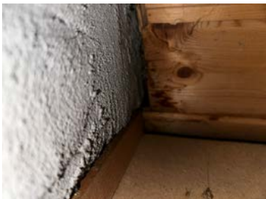
Fuktskjolder i undertak ved pipe.
