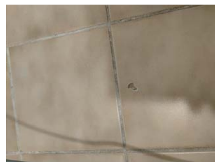
Avskalling i flis.
