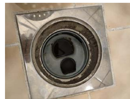
Sluk på vaskerom.
