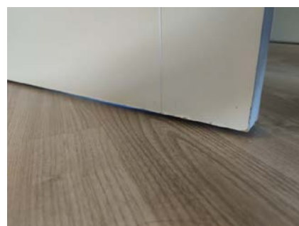
Små fuktsveller i bunn av baderomsdør.
