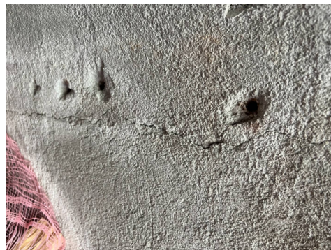
Sprekkdannelse på yttermur
