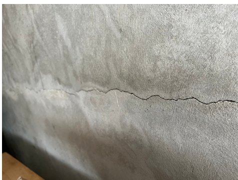
Sprekk i yttermur
