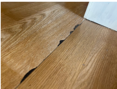
Stedvis slitasje på overflater
