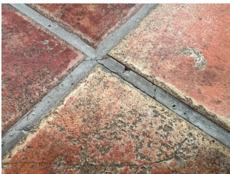
Bom (hullrom) med sprekkdannelse i fuger på fliser i vindfang
