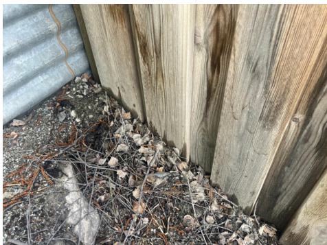
Utsatt for fuktpåkjenning ved garasje
