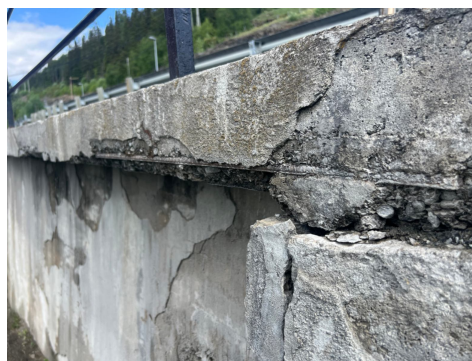
Forvitring og deformasjon av mur
