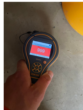
Ved overflatesøk av betongkonstruksjon var det fuktutslag
