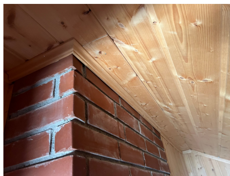
Brennbar material er inntil skorstein
