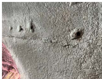
Sprekkdannelse på yttermur
