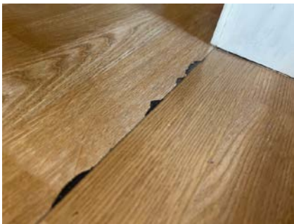
Stedvis slitasje på overflater
