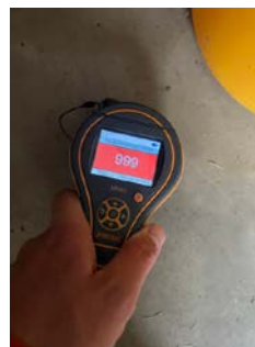
Ved overflatesøk av betongkonstruksjon var det fuktutslag
