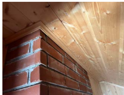
Brennbar material er inntil skorstein
