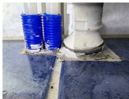
Synlig tettesjikt ved rør, men ikke mansjetter
