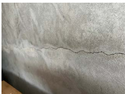
Sprekk i yttermur
