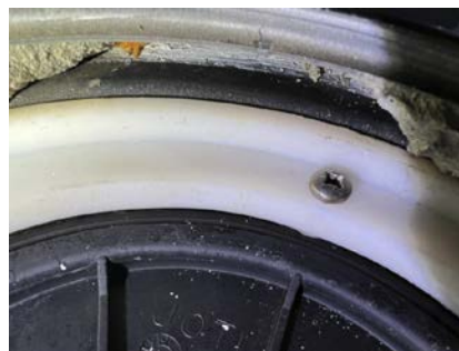
Ikke tettesjikt under klemring
