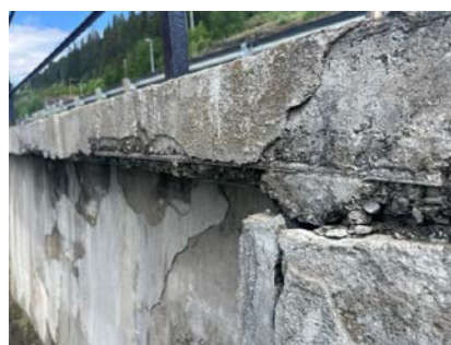
Forvitring og deformasjon av mur
