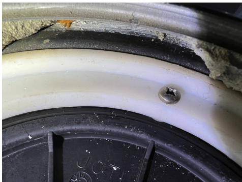
Ikke tettesjikt under klemring
