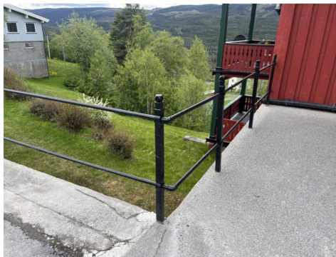
Rekkverk har lav høyde og for store åpninger der sikringstiltak bør foretas ved inngangsparti og ved støttemurer
