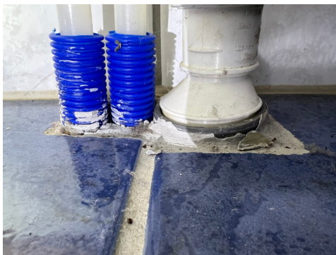
Synlig tettesjikt ved rør, men ikke mansjetter
