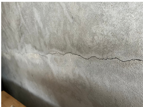
Sprekk i yttermur
