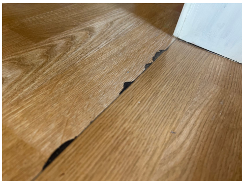
Stedvis slitasje på overflater
