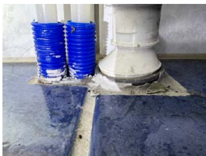
Synlig tettesjikt ved rør, men ikke mansjetter
