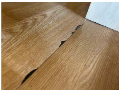
Stedvis slitasje på overflater
