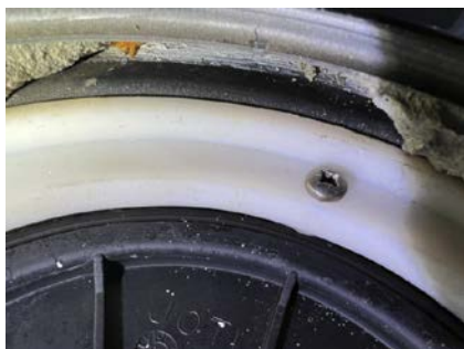
Ikke tettesjikt under klemring
