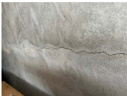
Sprekk i yttermur
