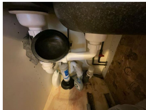
Synlige rør under kjøkkenbenken i 1. etasje.
