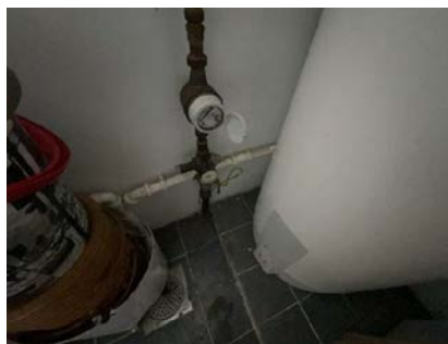
Stoppekran og vannmåler.
