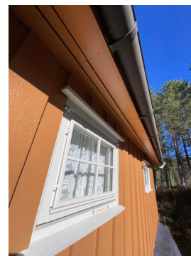
Små luftespalter i raftekasse ved inngang hytta
