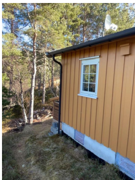
Takrenne i front av aluminium med nedløp til terreng montert 1996
