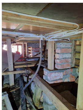
Selger opplyser at hytten var hevet før dem kjøpte den 1993 noe som er synlig på fundamenter under hytten
