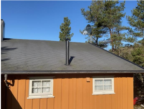
Lufterør til muldo er ikke fjernet ved montering av Jets toalett.
