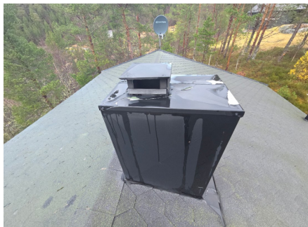
Pipehatt har noe avskaling på plastisolbelegget.
