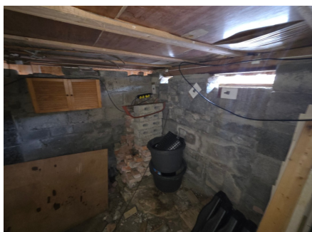
Selger opplyser at hytten var hevet før dem kjøpte den 1993 noe som er synlig på fundamenter under hytten
