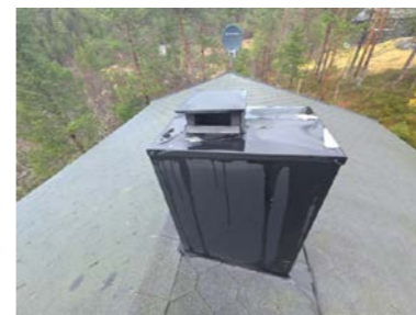
Pipehatt har noe avskaling på plastisolbelegget.
