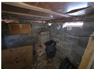
Selger opplyser at hytten var hevet før dem kjøpte den 1993 noe som er synlig på fundamentet under hytten
