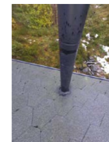
Lufterør til muldo er ikke fjernet ved montering av Jets toalett. Kan fjernes om det er ønskelig ifb. bytte av takteking
