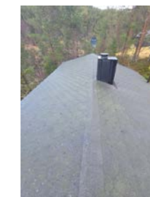
Oversikt mot pipehatt og lufterør
