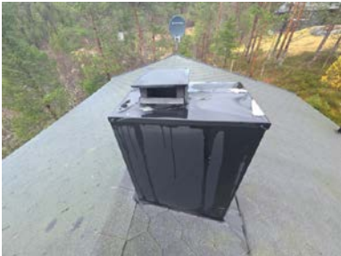
Pipehatt har noe avskaling på plastisolbelegget.
