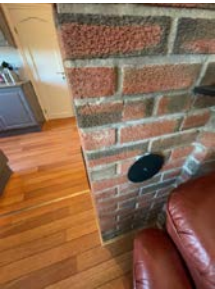
Tidligere åpning i pipe er tettet med godkjent lokk/luke.
