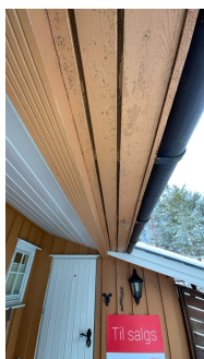
Synlige luftespalter i raftekasse på oversiden
