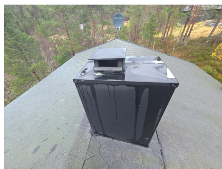
Pipehatten har noe avskalling på plastisolbelegget. Bilde er tatt ved befaringen 2025
