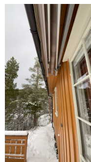
Begrenset ventilering i raftekasse på forsiden
