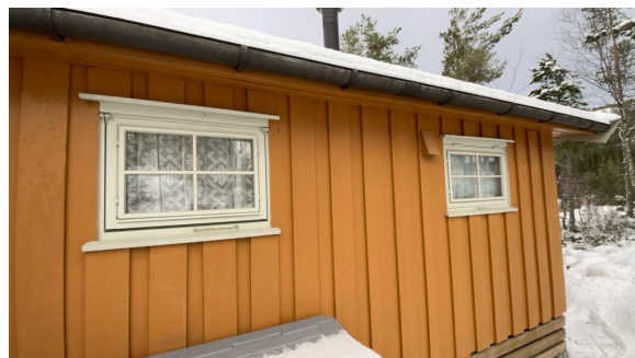
Vindu i gang og toalett. Vindu på toalett er punktert.
