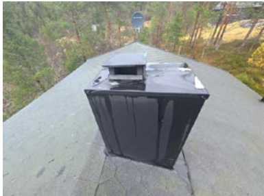
Pipehatten har noe avskalling på plastisolbelegget. Bilde er tatt ved befaringen 2025
