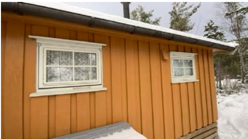
Vindu i gang og toalett. Vindu på toalett er punktert.
