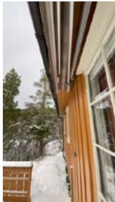
Begrenset ventilering i raftekasse på forsiden
