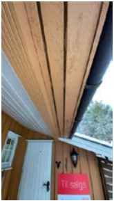
Synlige luftespalter i raftekasse på oversiden
