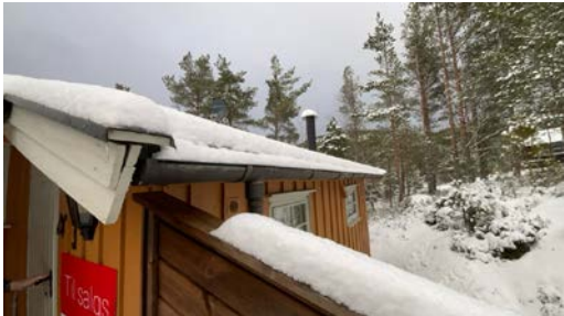
PVC takrenner på oversiden
