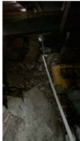
Takvann fra oversiden ledes ned til avløp i kjelleren.
