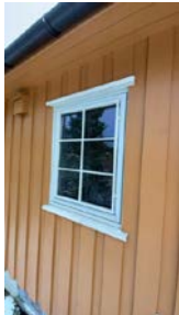
Vindu på kjøkken fra 2007 som er montert 2013
