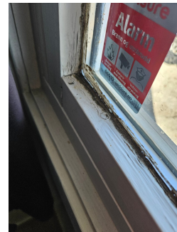
Fukt i karm som følge av kondens.
