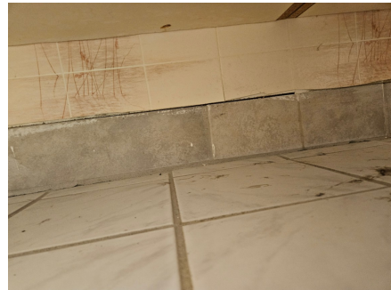
Sprekk i overgang vegg/gulv
