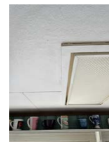
Fuktskade i himling ved lampe.
