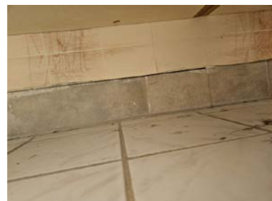
Sprekk i overgang vegg/gulv
