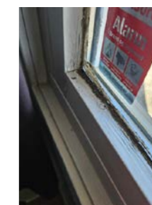
Fukt i karm som følge av kondens.
