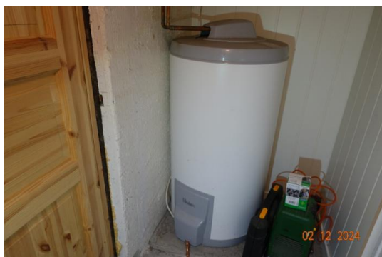
VVS tank kjeller.
