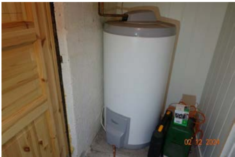
VVS tank kjeller.
