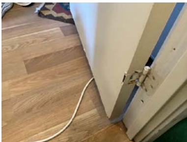
Fuktskader på dørbladet.
