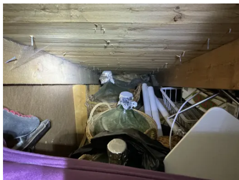
Noe steder er det ikke lufte-spalte mellom isolasjon og su-tak og lufting blir redusert.
