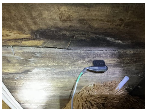
Fukt/råteskade i undertak.
