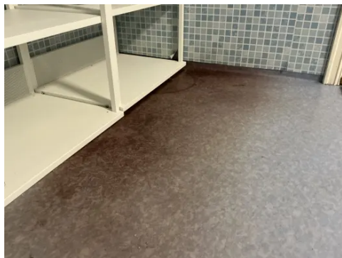
Misfarging/svimerker på belegg.
