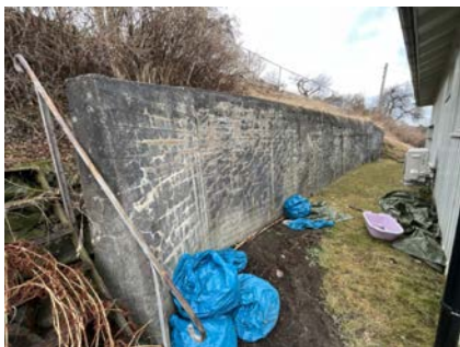
Terrang som skråner mot grunnmur.
