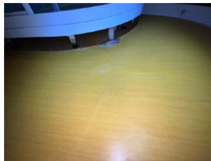
Sprekker i fuger på gulvbelegg.
