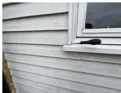
Registrert begynnende råteskade i utvendig belistning på enkelte vinduer.
