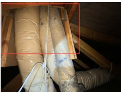
Fuktskjolder på kasse av sponplater til rørgjennomføringer i yttertak.
