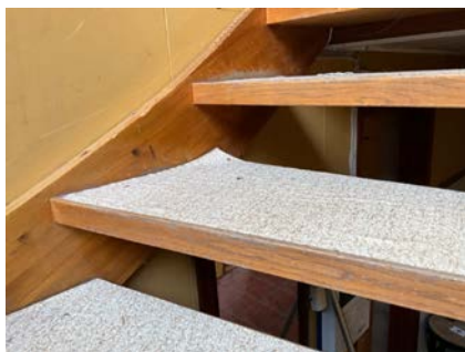
Løst belegg i trapp.
