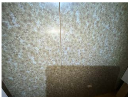
Sprekker i plateskjøter.
