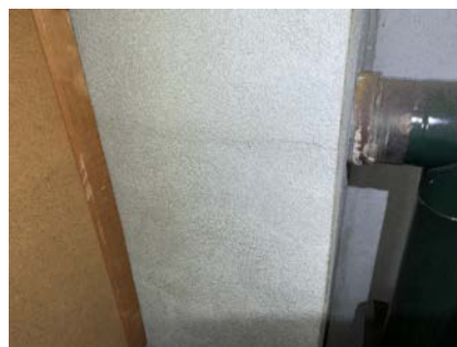
Riss i pipevange
