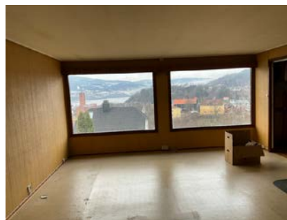
Vinduer i stuen har punkterte glass.
