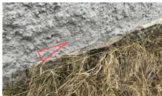
Sprekk i murpuss på grunnmur mot vest.
