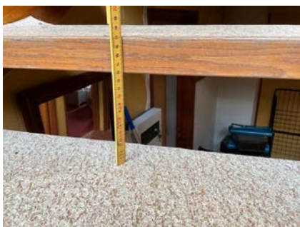
Åpning større enn 10cm mellom opptrinn.
