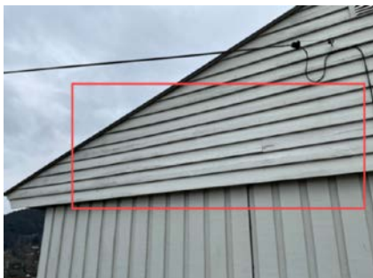
Sprekker og råteskader i liggende kledning på gavelvegg mot sør.
