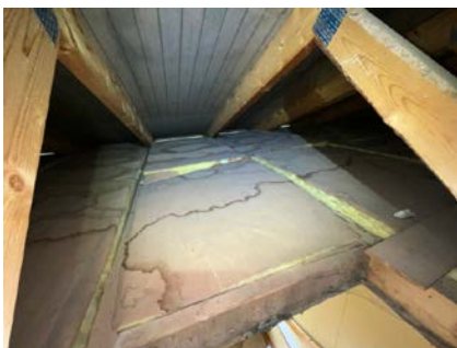
Fuktskjolder på papir på isolasjonen.
