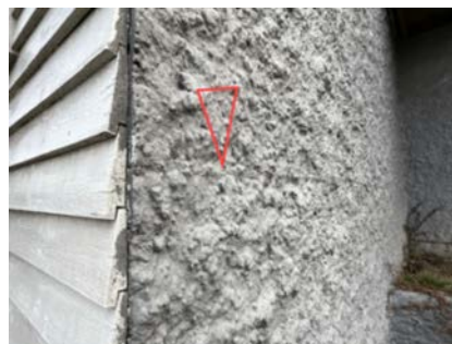
Sprekk i murpuss ved hjørne mot sør-vest.
