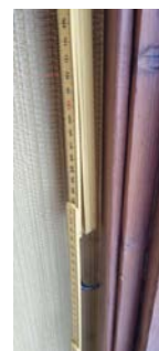
Måling av planavvik i stue. Laserstrek viser 1113mm.
