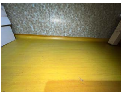
Avskalling nederst på baderomsplater
