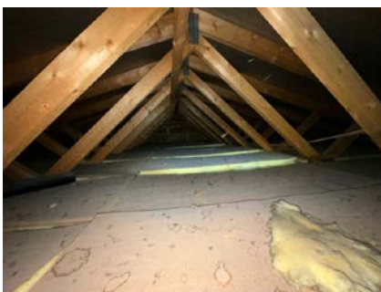
Fuktskjolder på papir på isolasjonen.
