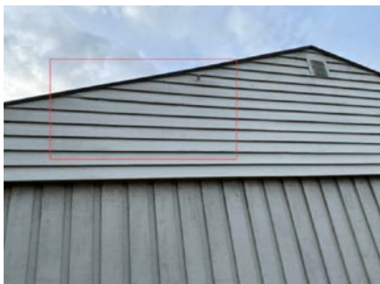
Råteskader på liggende kledning på gavelvegg mot nord.
