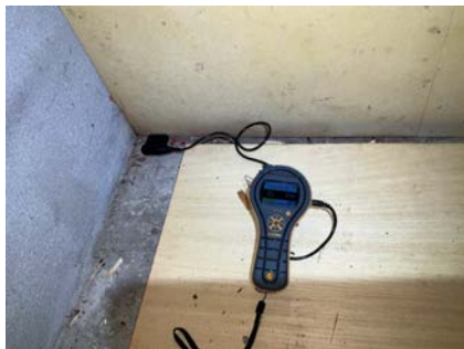
Fuktmåling med pigge i påforet vegg på mur i kjellerbod mot sør-øst. Fuktinnhold viser 17,6% fuktinnhold i trevirke.
