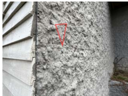
Sprekk i murpuss ved hjørne mot sør-vest.
