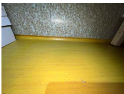
Avskalling nederst på baderomsplater
