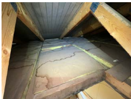
Fuktskjolder på papir på isolasjonen.
