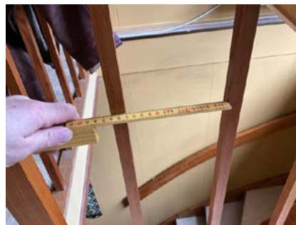
Åpning større enn 10cm i rekkverk.
