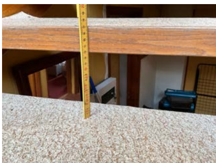
Åpning større enn 10cm mellom opptrinn.
