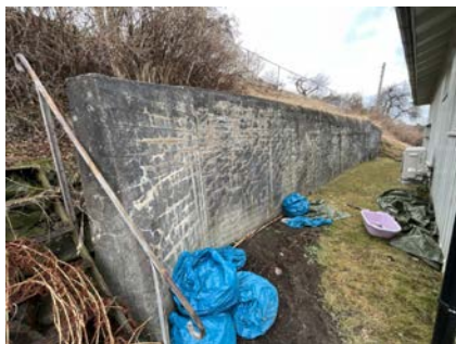
Terrang som skråner mot grunnmur.
