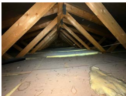
Fuktskjolder på papir på isolasjonen.
