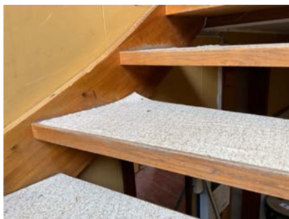
Løst belegg i trapp.
