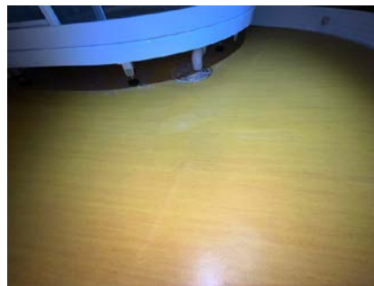
Sprekker i fuge på gulvbelegg.
