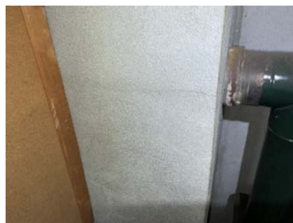
Riss i pipevange
