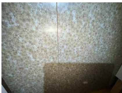
Sprekker i plateskjøter.
