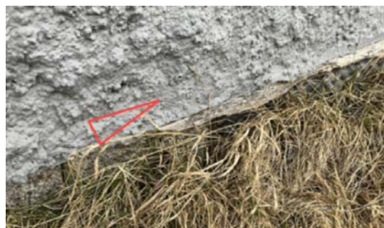
Sprekk i murpuss på grunnmur mot vest.
