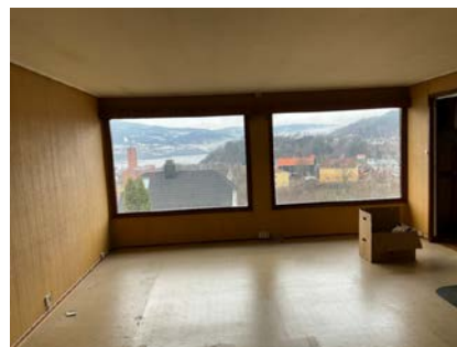
Vinduer i stuen har punkterte glass.
