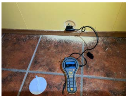
Fuktmåling med pigg i påforet vegg på mur. Fuktmåling viser 11,5% fuktinnhold i trevirke.
