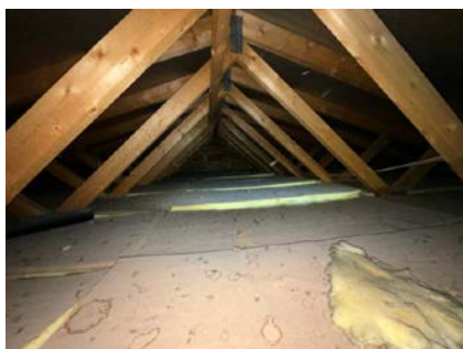
Fuktskjolder på papir på isolasjonen.
