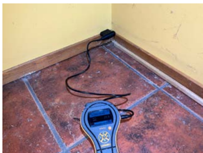
Fuktmåling med pigg i påforet vegg på mur under trapp i hall. Fuktmåling viser 21,3% fuktinnhold i trevirke.
