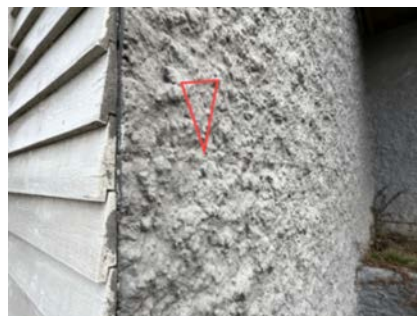
Sprekk i murpuss ved hjørne mot sør-vest.
