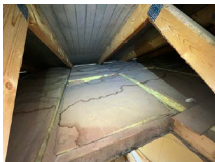
Fuktskjolder på papir på isolasjonen.
