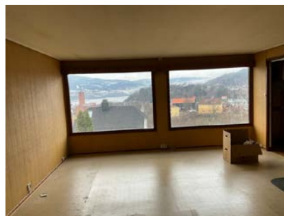
Vinduer i stuen har punkterte glass.
