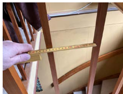
Åpning større enn 10cm i rekkverk.
