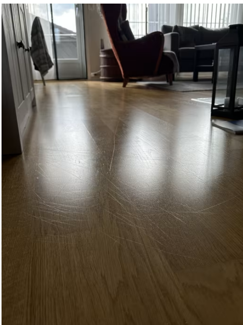
Viser riper og slitasje ved parkettgulv.
