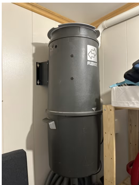
Viser sentralstøvsuger plassert i bod. Opplyst defekt, anbefaler ytterligere undersøkelser.
