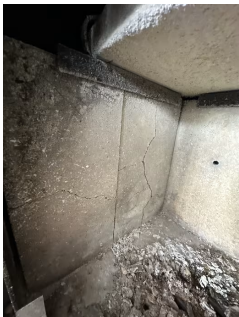
Brannsteiner i vedovn med sprekker og slitasje.
