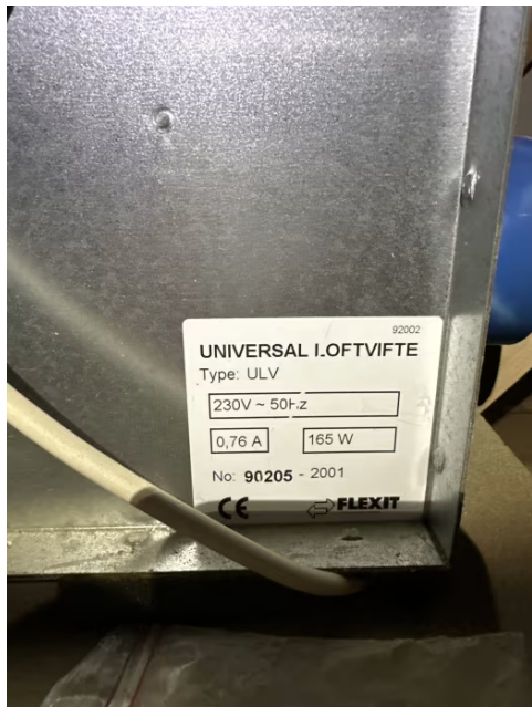
Viser teknisk data på vifte. Vifte fra 2001.
