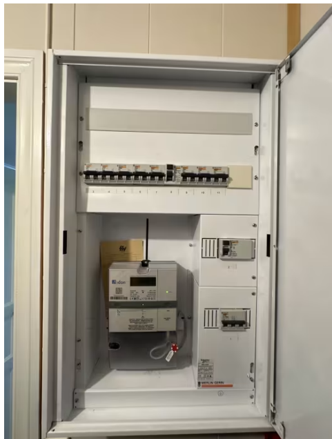
Viser sikringskap plassert i bod.
