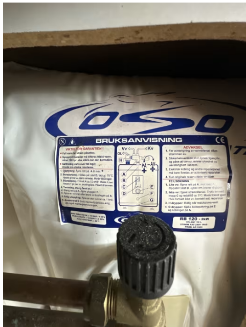
Viser teknisk data på bereder.
