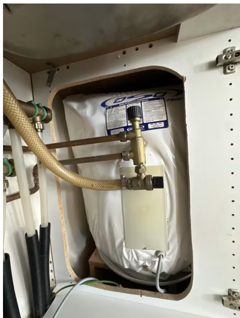
Viser bereder plassert i hjørneskap på kjøkken.
