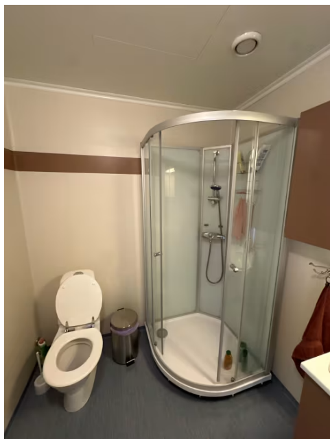
Viser gulvstående toalett og dusjkabinett.
