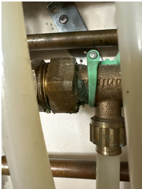
Det registreres irr på koblinger.
