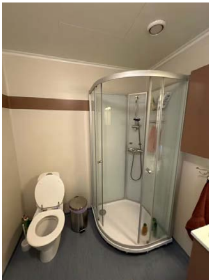
Viser gulvstående toalett og dusjkabinett.
