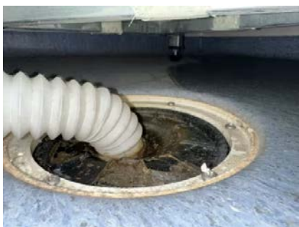
Sluk anbefales rengjort og en ytterligere undersøkelse anbefales.
