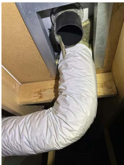
Det er påvist fuktskjolder i undertak/takkonstruksjon.
