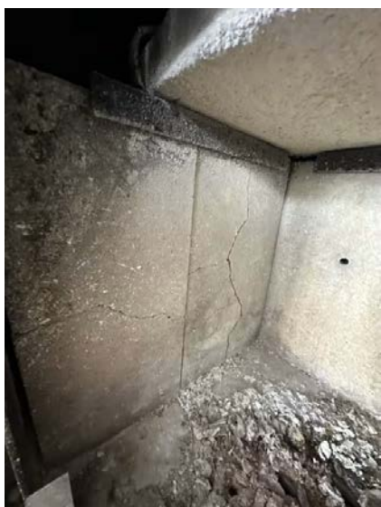
Brannsteiner i vedovn med sprekker og slitasje.
