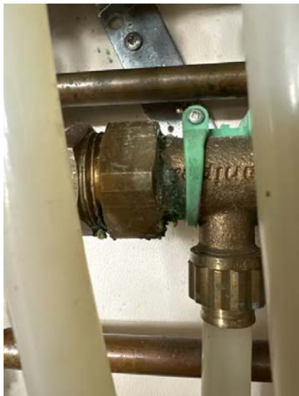
Det registreres irr på koblinger.
