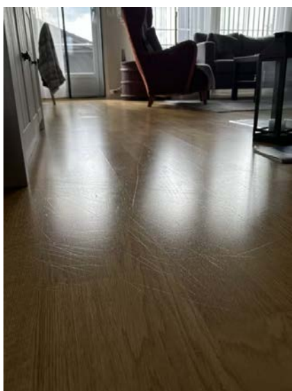
Viser riper og slitasje ved parkettgulv.
