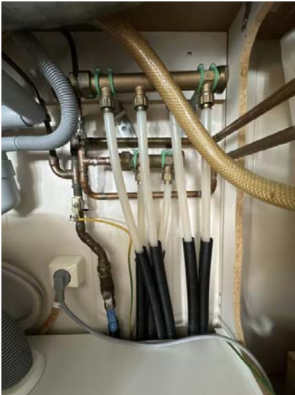
Viser hovedstoppekran og åpen rørfordeling plassert under oppvaskkum.
