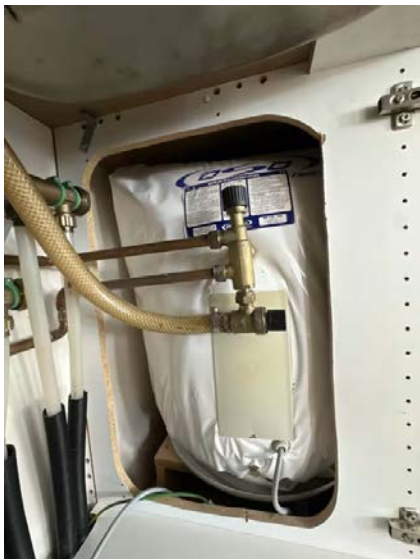
Viser bereder plassert i hjørneskap på kjøkken.
