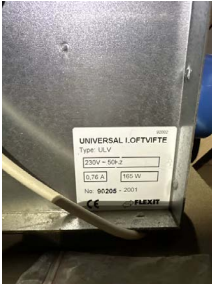
Viser teknisk data på vifte. Vifte fra 2001.
