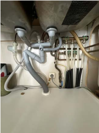
Viser vann og avløpsinstallasjoner under kum. Vanninntak, åpne fordelere og hovedstoppekran.
