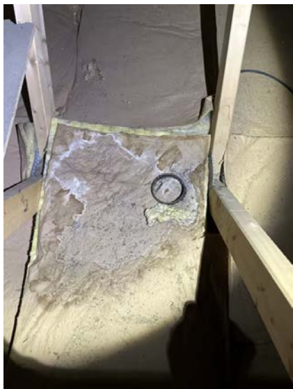
Det er påvist fuktskjolder på isolasjonsplate under luftehatt.
