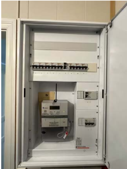
Viser sikringsskap plassert i bod.
