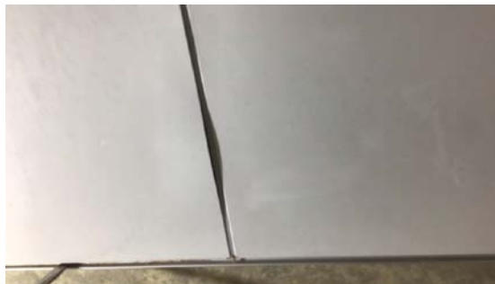
Fukt skader i skjøt
