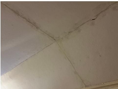
Det registreres slitte overflater med behov for oppgraderinger.
