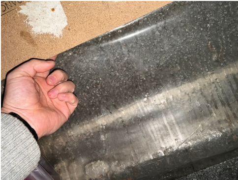
Det er fukt på dampsperre i trapperom. Dette kan skyldes fukt fra kjeller som legger seg på plasten.
