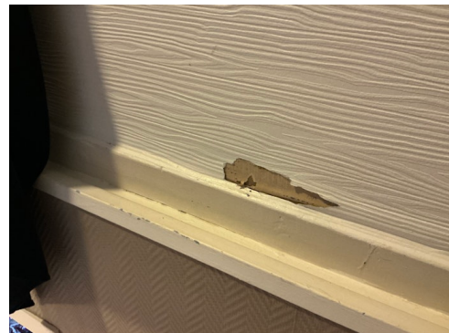
Det registreres løs tapet flere steder i boligen.
