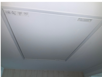
Aggregat for ventilasjon
