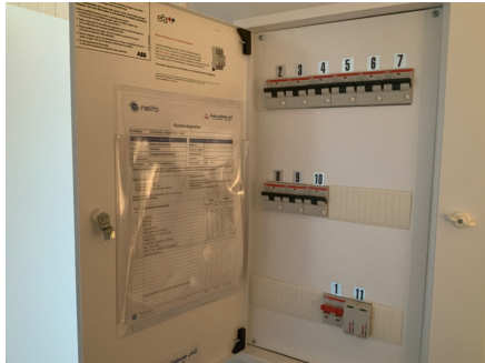
Sikringskap med automatsikringer.
