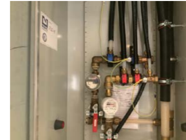
Samleskap med rørkurser og stoppekraner
