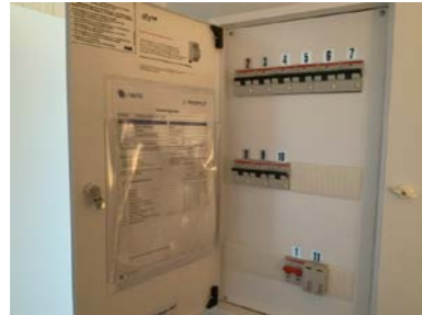
Sikringskap med automatsikringer.
