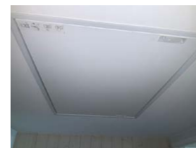
Aggregat for ventilasjon
