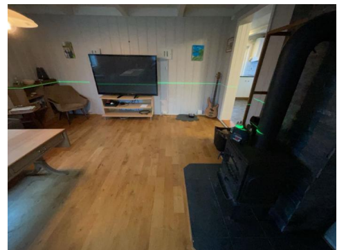
Plassering av laser ved kontroll av stue. Det er målt 47 mm høydeforskjell gjennom rommet. TG 3. Over en avstand på 2 meter er det målt 20 mm fra hjørne mot gang til gulv foran vedovn. TG 2
