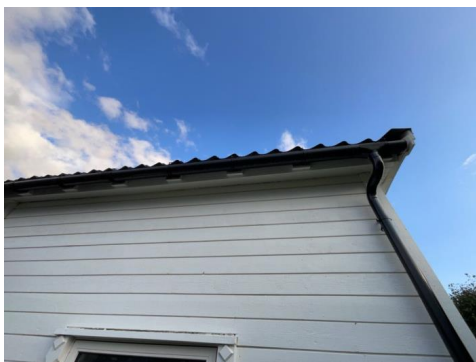
Ingen synlig ventilering i raftekasse ved overgang tak/vegg
