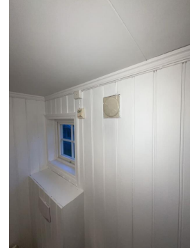
Ventil og åpningsvindu på toalettrom
