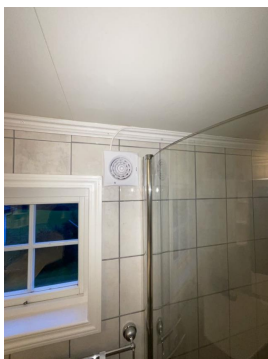
Mekanisk avtrekksvifte og åpningsvindu på bad
