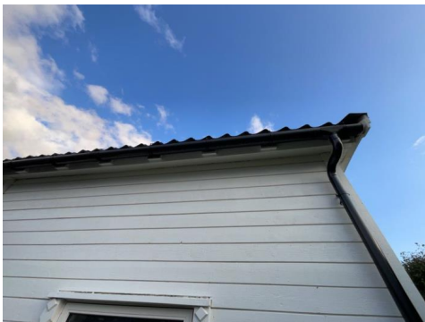
Ingen synlig ventilering i raftekasse ved overgang tak/vegg
