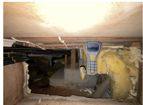
Fuktmåling i rom under terreng. Måling viser 18,2% ved åpning til krypkjeller under bad.
