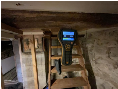
Fuktmåling i rom under terreng. Måling viser 18,1% ved trapp mot stue.
