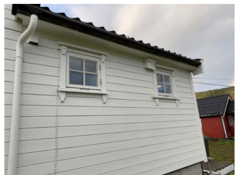
Koblede vindu på toalett og bad
