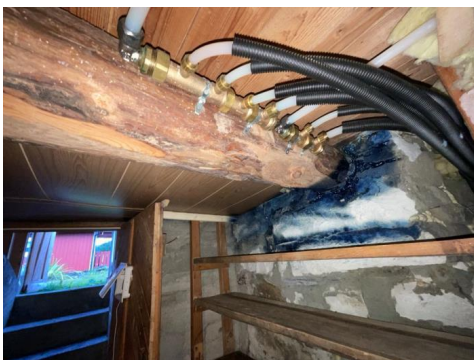
Fordelerkolber på kaldt og varmt vann
