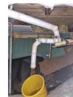
Det er etablert mulighet for å tappe ned røranlegg i teknisk rom
