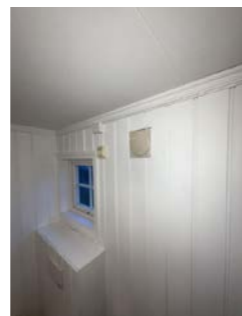
Ventil og åpningsvindu på toalettrom
