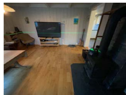
Plassering av laser ved kontroll av stue. Det er målt 47 mm høydeforskjell gjennom rommet. TG 3. Over en avstand på 2 meter er det målt 20 mm fra hjørne mot gang til gulv foran vedovn. TG 2
