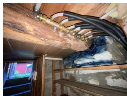
Fordelerkolber på kaldt og varmt vann
