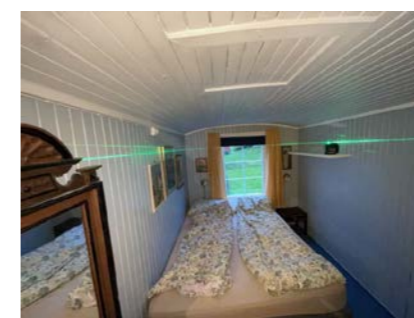
- Plassering av laser ved kontroll av soverom 3. Det er målt 15 mm høydeforskjell gjennom rommet. TG 2.
