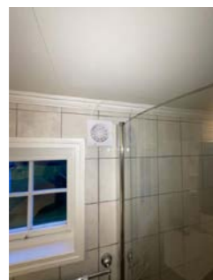
Mekanisk avtrekksvifte og åpningsvindu på bad
