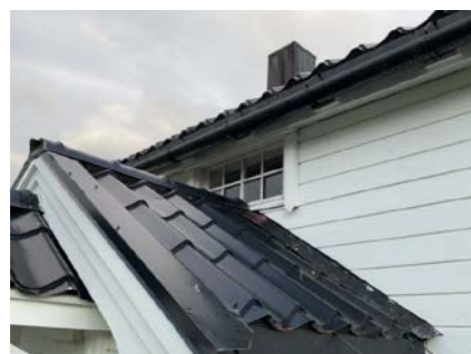
Enkelt vindu på loftsgang
