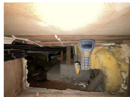
Fuktmåling i rom under terreng. Måling viser 18,2% ved åpning til krypkjeller under bad.
