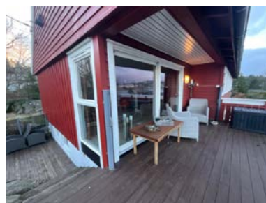
28 mm skjevhet i taket over veranda.
