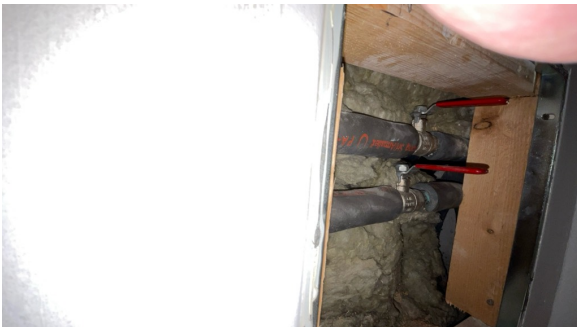
Test av stoppekraner.
