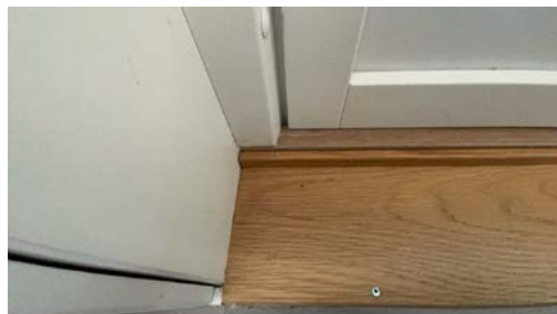
Dør tar i terskel.
