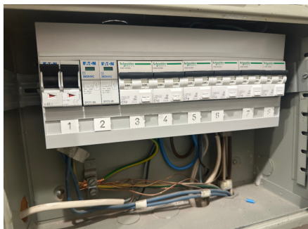
Sikringsskap med automatsikringer.
