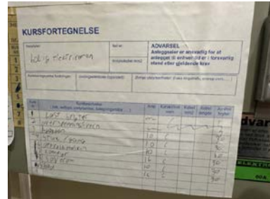
Kursoversikt i sikringsskap
