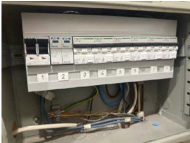
Sikringsskap med automatsikringer.
