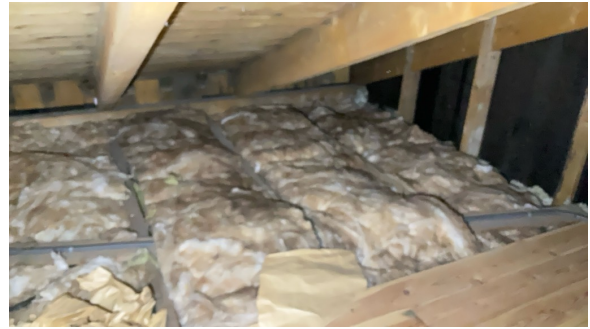
Manglende lufting med mot yttervegg.
