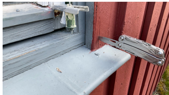
Råte i kledning ved vindu.
