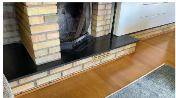
Manglende plate på guv foran åpen peis.
