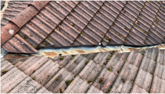
Knekte og løse takstein i gradrenner.
