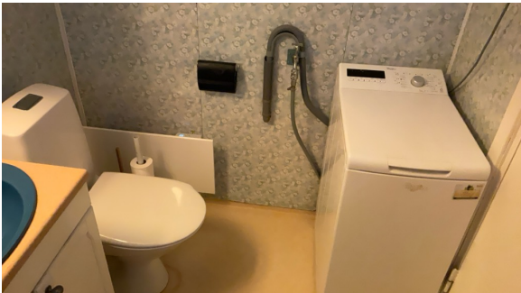
Opplegg til vaskemaskin og toalett.
