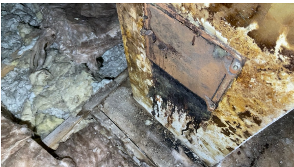
Sotvann under feieluke på loft.
