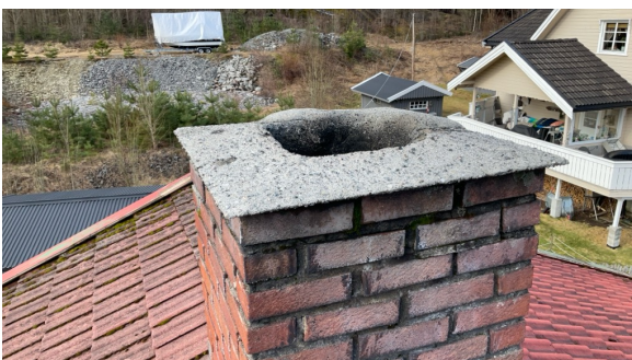
Manglende topphatt på pipe.
