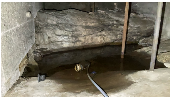
Fritt vann i krypkjeller.
