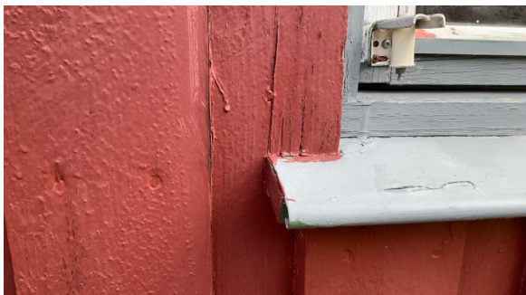
Manglende glipe ned mot vindusbrett.
