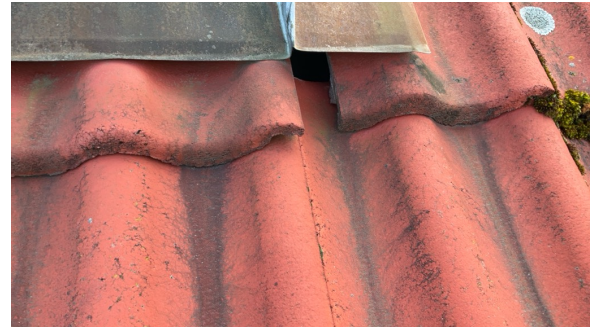
Manglende takstein ved pipe.
