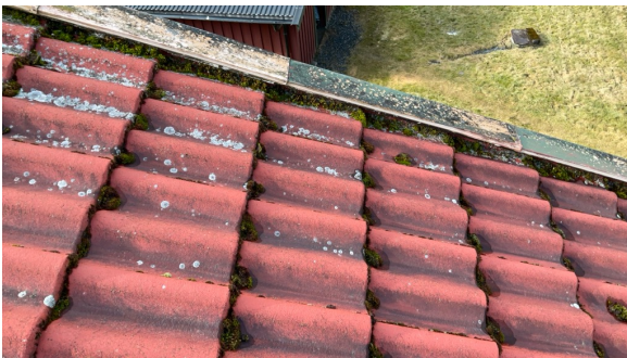
Dekkbord på vindskier er slitt.
