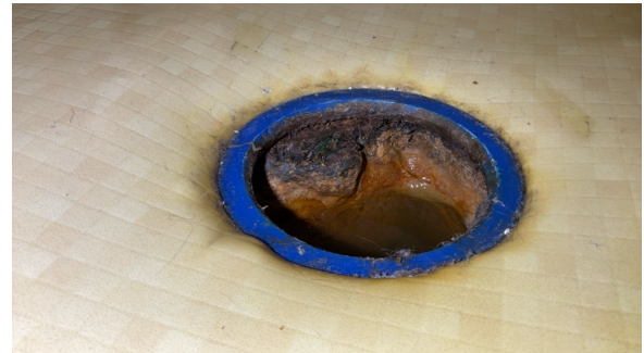
Støpejernssluk med rust.
