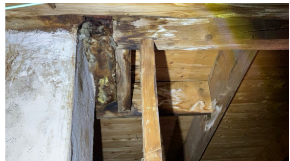
Noe fuktmerker ved gjennomføring på loft.
