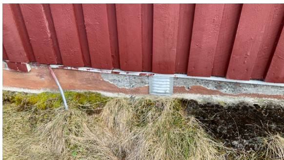
Løs puss og manglende puss på grunnmur.
