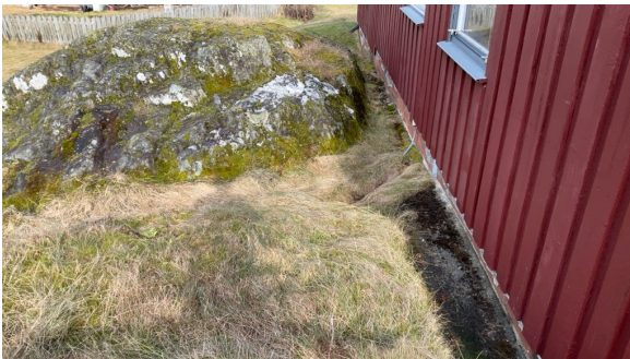
Fall mot grunnmur.
