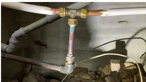
Noe irr på vannrør i kjeller
