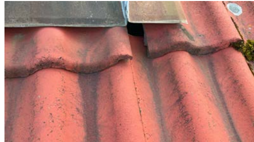
Manglende takstein ved pipe.
