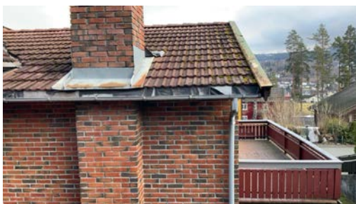
Rust på pipebeslag og flassing i overflatebehandling på takrennebeslag.
