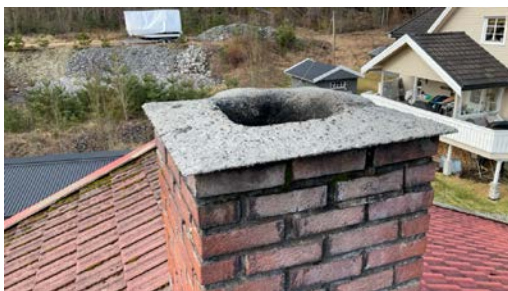
Manglende topphatt på pipe.
