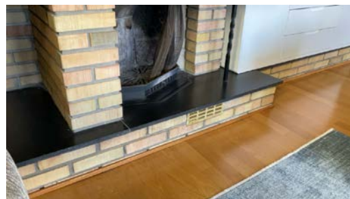
Manglende plate på guv foran åpen peis.
