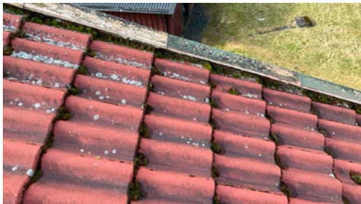
Dekkbord på vindskier er slitt.
