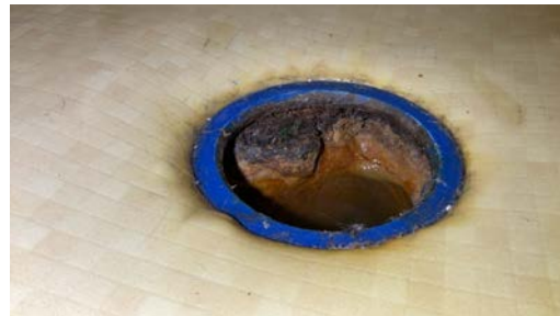
Støpejernssluk med rust.
