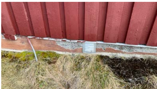
Løs puss og manglende puss på grunnmur.
