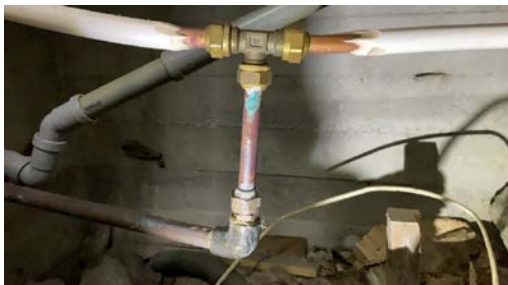
Noe irr på vannrør i kjeller
