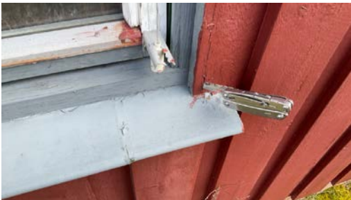
Råte i kledning vindu 2.
