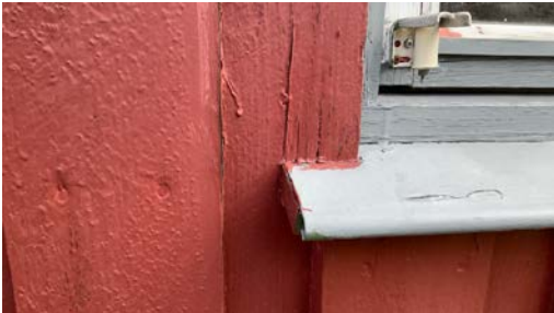
Manglende glipe ned mot vindusbrett.
