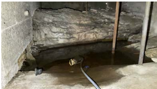
Fritt vann i krypkjeller.
