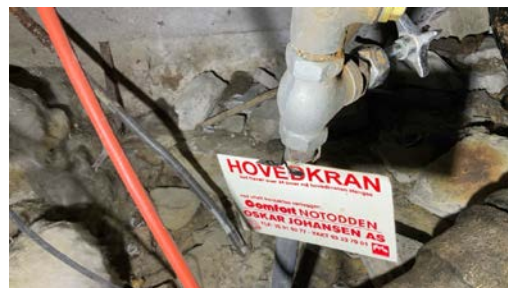
Stoppekran merket i krypkjeller.
