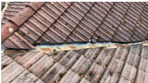
Knekte og løse takstein i gradrenner.
