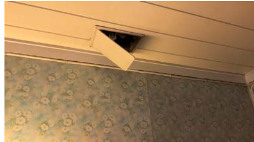
Naturlig lufting i tak.
