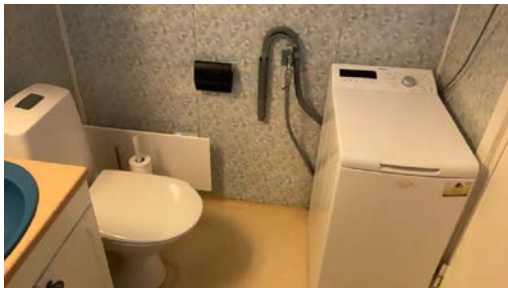
Opplegg til vaskemaskin og toalett.
