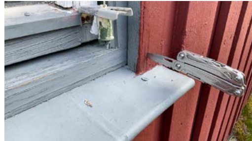
Råte i kledning ved vindu.
