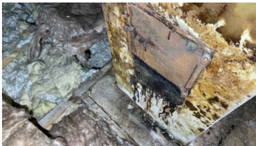
Sotvann under feieluke på loft.
