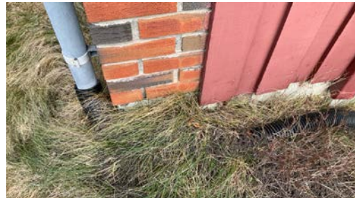
Noe kort avstand fra terreng til underkant kledning.
