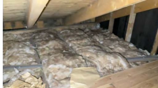
Manglende lufting med mot yttervegg.
