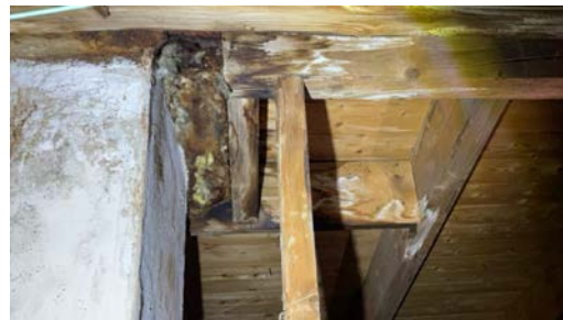
Noe fuktmerker ved gjennomføring på loft.
