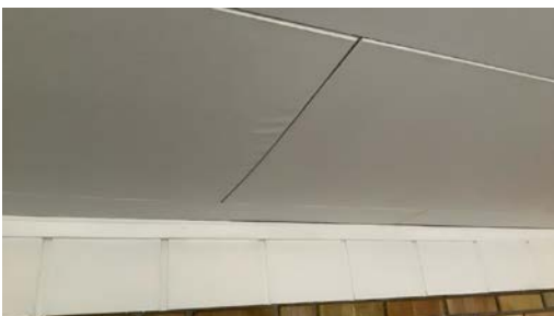
Skade på takplater i forbindelse med pipe i tilbygd stue.
