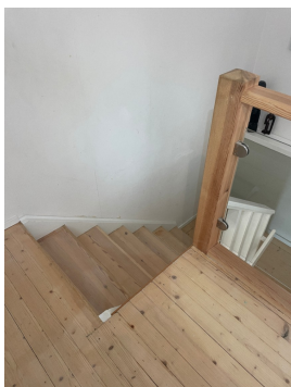
Manglende rekkverk ved trapp, samt kun 1 håndløper.
