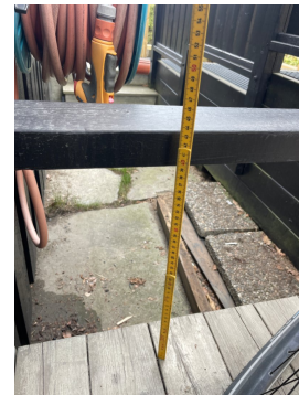
Rekkverk på terrasse vest side med avvik
