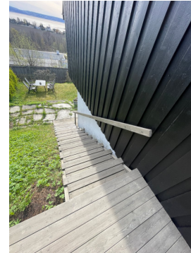
Utvendig trapp mangler håndløper begge sider
