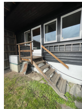
Trapp mot øst har avvik ihht regler
