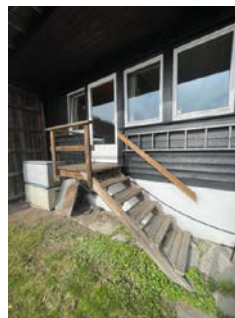
Trapp mot øst har avvik ihht regler
