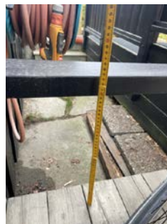
Rekkverk på terrasse vest side med avvik
