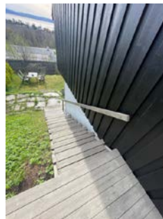
Utvendig trapp mangler håndløper begge sider
