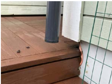
Tak-nedløp går ikke til bakke.
