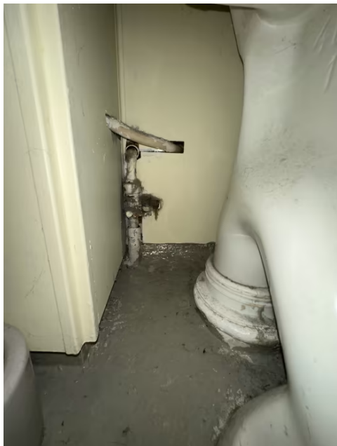
Mansjetter ikke påvist ved rørgjennomføringer.
