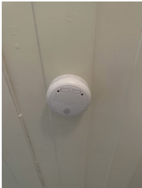
Brannvarsler ved inngang.
