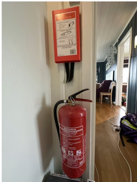
Viser håndslukker og brannteppe.
