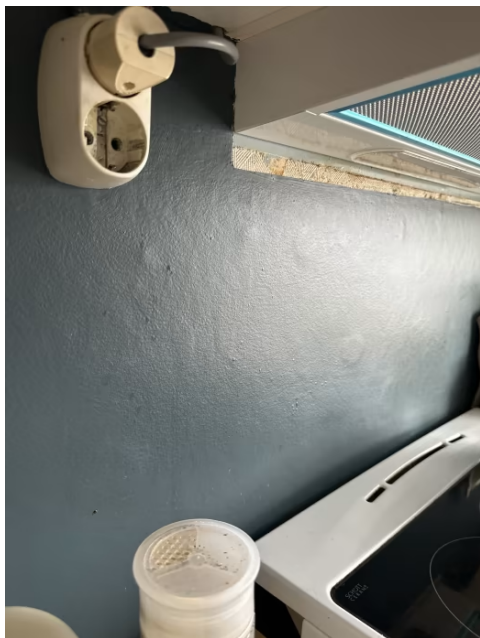
Registreres stedvis luftlommer bak belegg.
