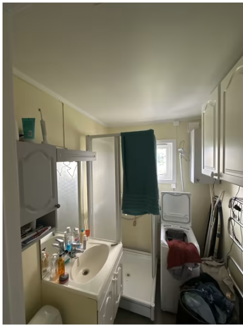
Viser baderomsinnredning, dusjkabinett og opplegg for vaskemaskin.
