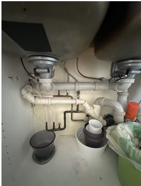
Viser vann og avløpsinstallasjoner under kum.
