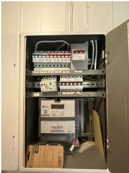
Viser sikringsskap plassert i trapperom. Avdekking anbefales montert over sikringer. Modul i skapet er løs.
