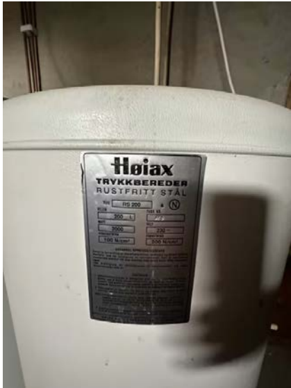
Teknisk data på bereder.
