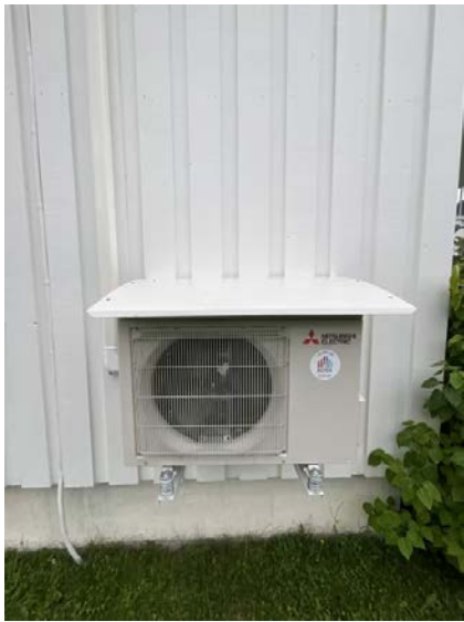
Viser utedel montert på nordvegg.
