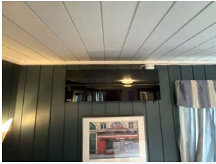
Viser innedel til varmepumpe montert i stue.
