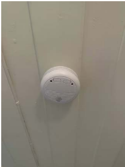
Brannvarsler ved inngang.
