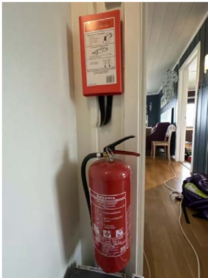
Viser håndslukker og brannteppe.
