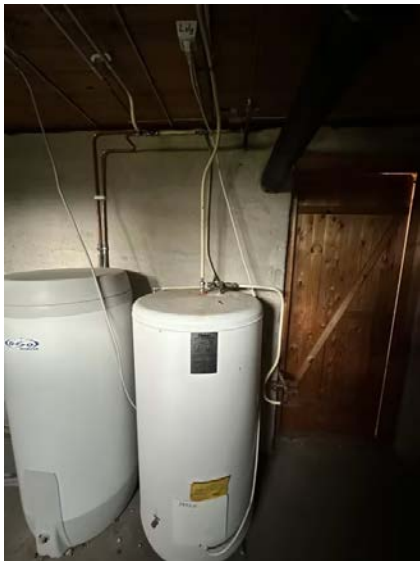
Viser plassering av beredere i kjeller.
