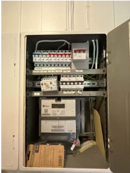
Viser sikringsskap plassert i trapperom. Avdekking anbefales montert over sikringer. Modul i skapet er løs.
