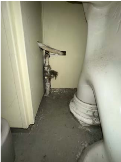
Mansjetter ikke påvist ved rørgjennomføringer.
