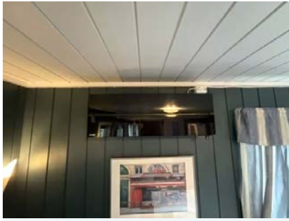
Viser innedel til varmepumpe montert i stue.
