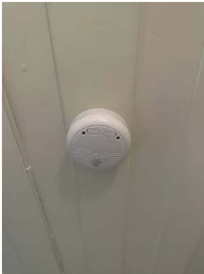
Brannvarsler ved inngang.
