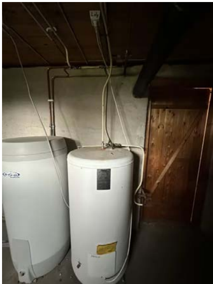
Viser plassering av beredere i kjeller.
