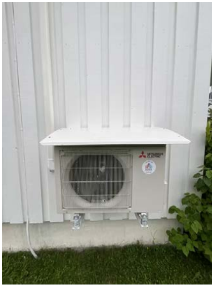
Viser utedel montert på nordvegg.
