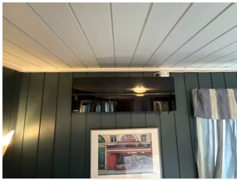
Viser innedel til varmepumpe montert i stue.
