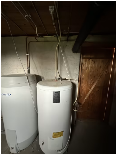
Viser plassering av beredere i kjeller.
