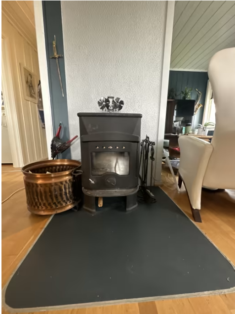
Viser vedovn plassert i stue. Gnistfanger ved gulv med metallplate.
