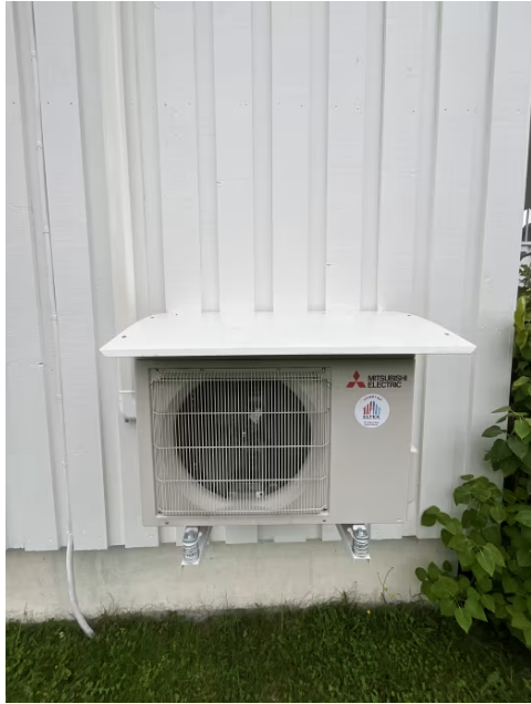
Viser utedel montert på nordvegg.
