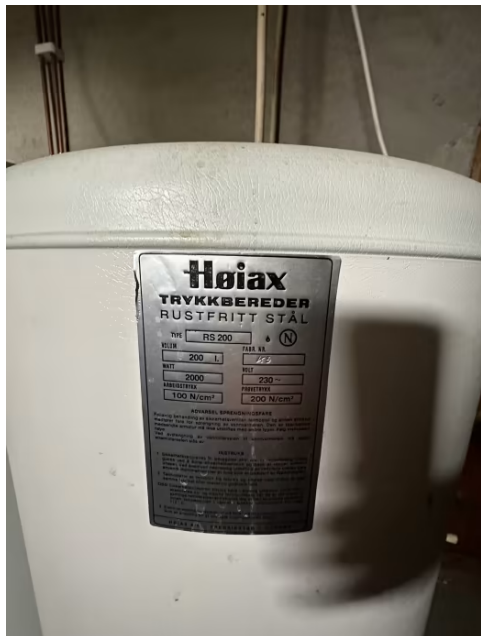
Teknisk data på bereder.
