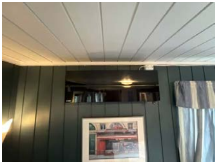
Viser innedel til varmepumpe montert i stue.
