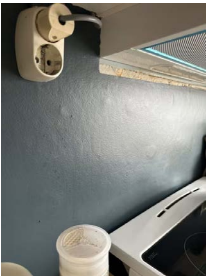
Registreres stedvis luftflommer bak belegg.
