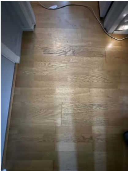
Parkettgulv ved inngang er slitt.
