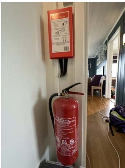
Viser håndslukker og brannteppe.
